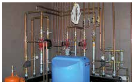
КОТЕЛЬНАЯ, Г. КИЕВ
