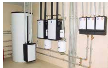
КОТЕЛЬНАЯ, Г. ХАРЬКОВ
