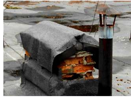
Зруйнована та «герметизована» витяжна шахта
