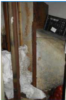
Зруйнована калориферна установка
