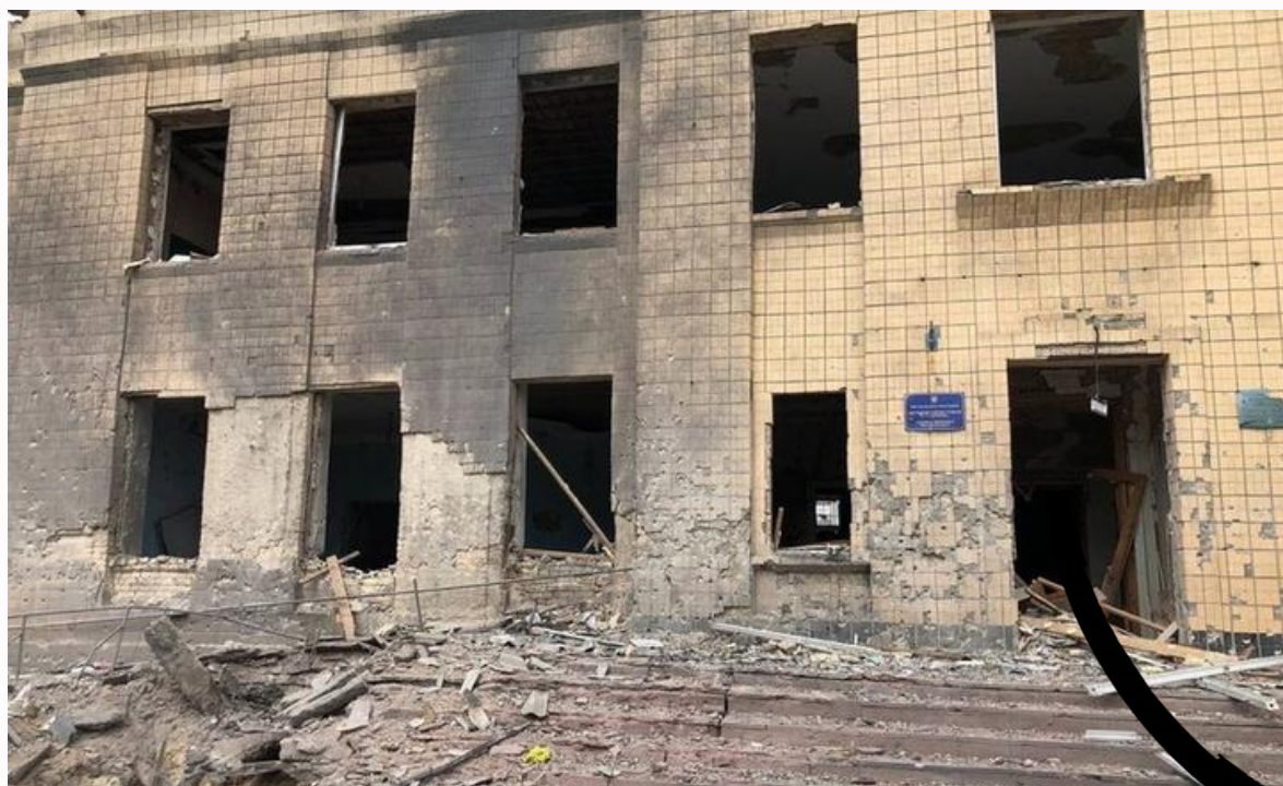
Зруйнована школа в м. Снігурівка, квітень 2023.
