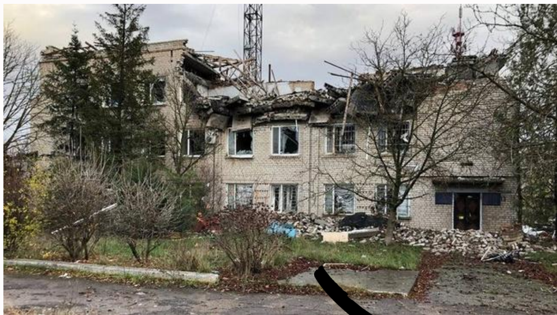
Пошкоджена будівля в Снігурівці. Листопад 2023 року.
